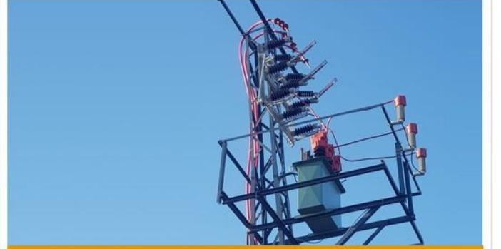
TRAFO VE ENERJİ HATTI
